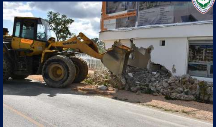
Codevial ha identificado 503 obras que violan el derecho de vía en las principales carreteras
